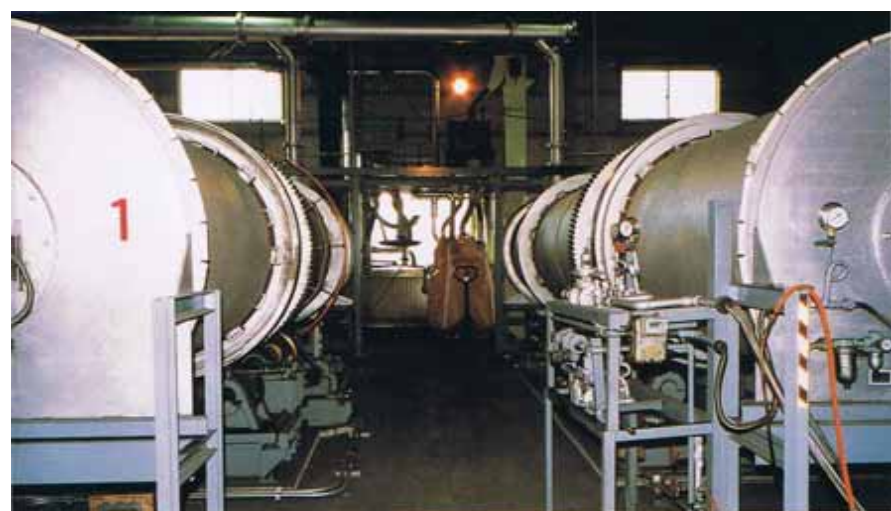
活性炭再生炉 (活性炭工場製造設備)
