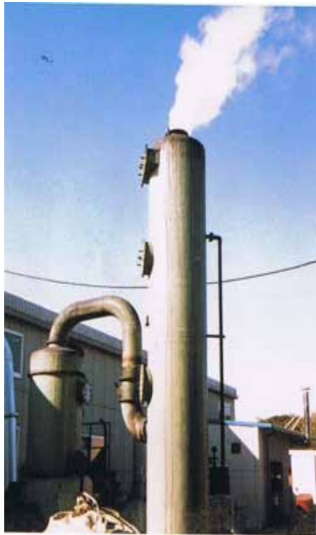
排ガス処理設備 (活性炭工場製造設備)
